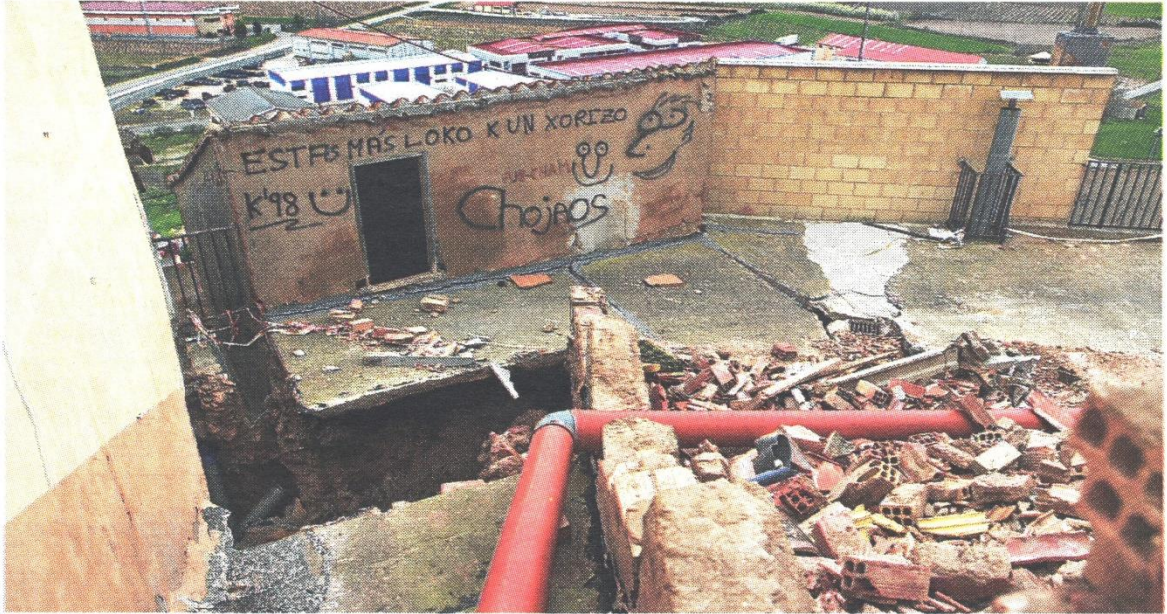
Tramo de calle del barrio de las bodegas que se hundió el pasado viernes. :: SONIA TERCERO
